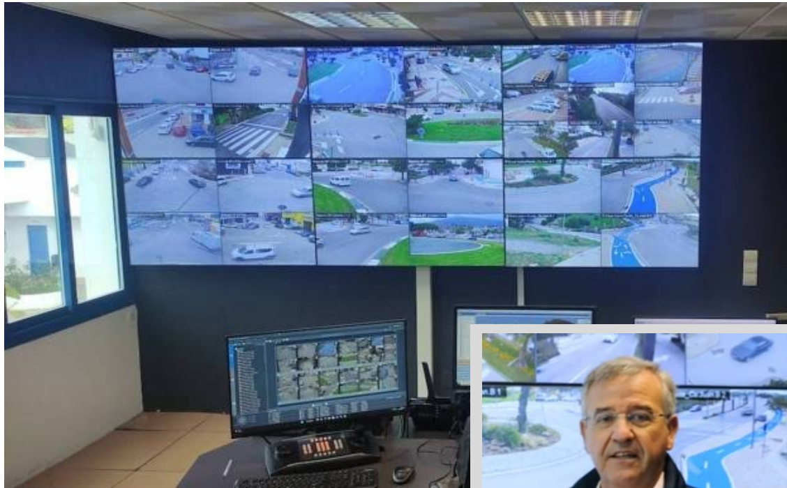
Centro de Control Policía Local de Estepona (Málaga).
